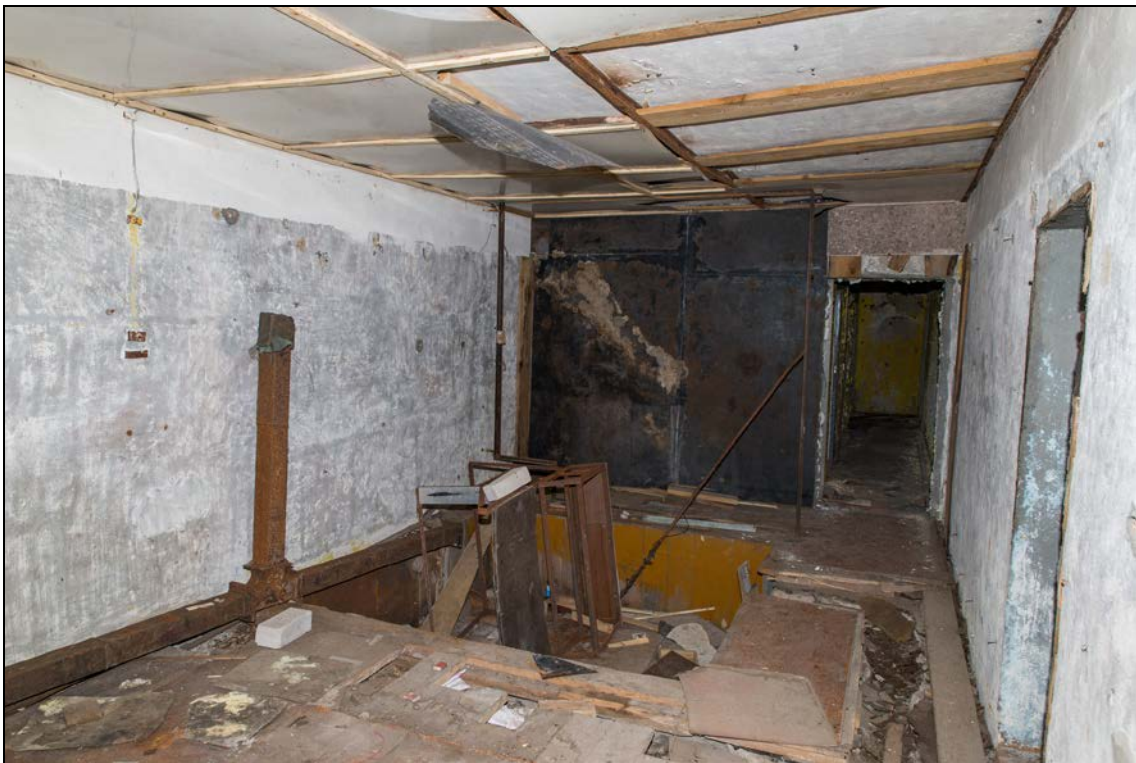
Foto 56 (0724). Ristna patarei. Elektriijaam/komandokeskus [9]. Radarijaama juhtimiskeskuse ruum on kõige suurem, 23 m 2 .
