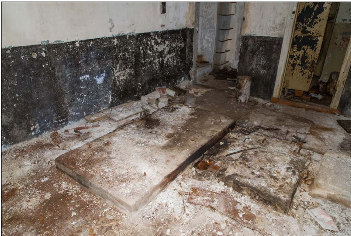
Foto 58 (0755). Ristna patarei. Elektriijaam/komandokeskus [9]. Diisलगенерааторите ruum on üks suuremaid, pindala 17,5 m 2 . Foto Mart Mõniste 5.03.2014.
