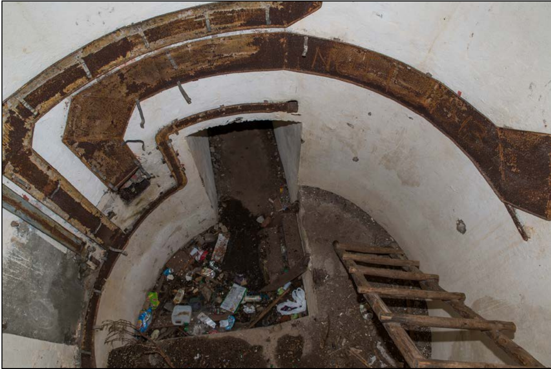
Foto 45 (1062). Ristna patarei. Komandokeskus tulejuhtimistorniga [7]. Tulejuhtimistornis on kahe alumise korruse metalltrepid kaotsi läinud. Foto Mart Mõniste 5.03.2014.
