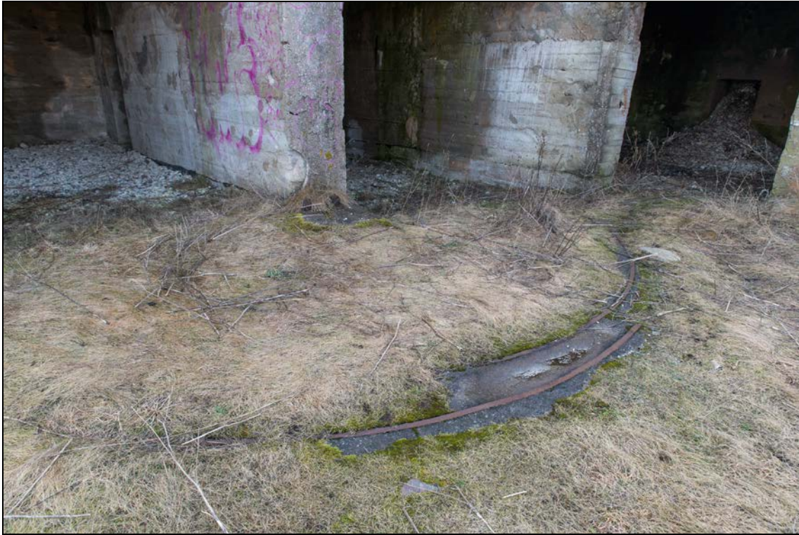
Foto 91 (1155). Ristna patarei. Angaari [23] ees on uste liigutamise relsid, aga tundub, et uksi pole kunagi paigaldatud.
